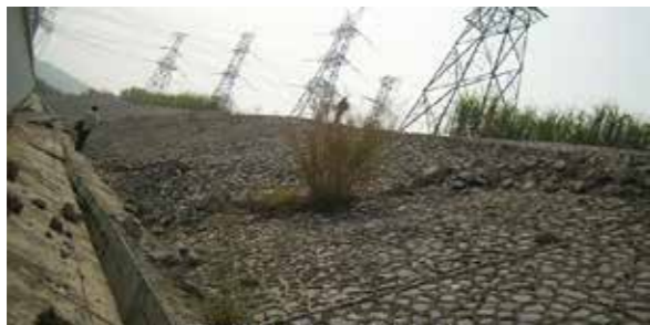
图1 边坡破坏(坡脚与坡面)
